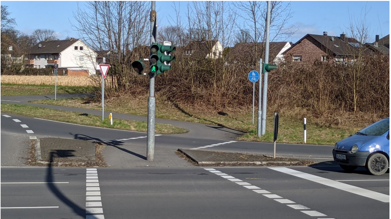
Abbildung 2: Kreuzung Feldmühlestraße/Porzer Straße. Hier weist die Streuscheibe im Blinklicht auf den Radverkehr hin, doch eine Roteinfärbung mit Fahrradpiktogrammen, die den Zweirichtungsverkehr anzeigen, fehlt. Das Vz 205 (Vorfahr beachten) müsste vor der Furt stehen.
